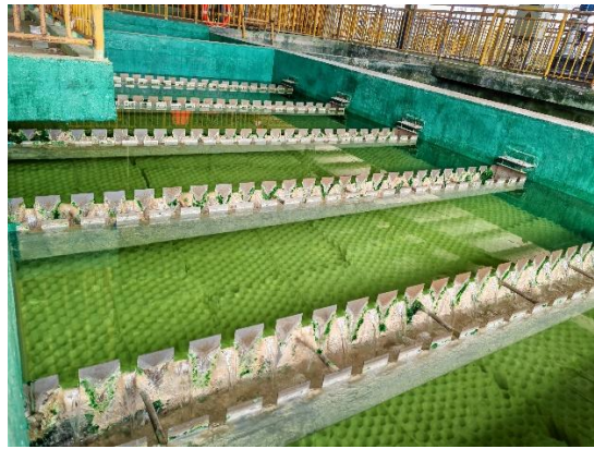
废水近零排放装置斜管沉淀池
