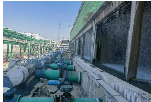
循环水系统循环水泵变频控制装置
