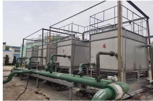
阳极组装闭式冷却塔
