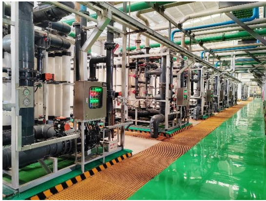
废水近零排放装置超滤设备
