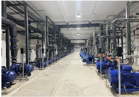
废水零排放装置
