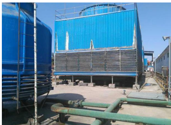
高洁净钢循环泵房节水设备
