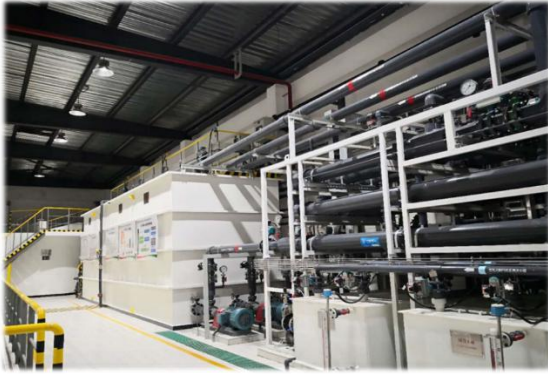
西宁发电分公司废水零排放系统
