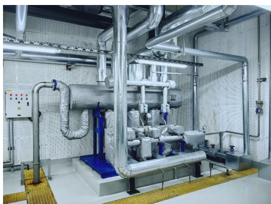
车间 MFP 冷凝水回收装置
