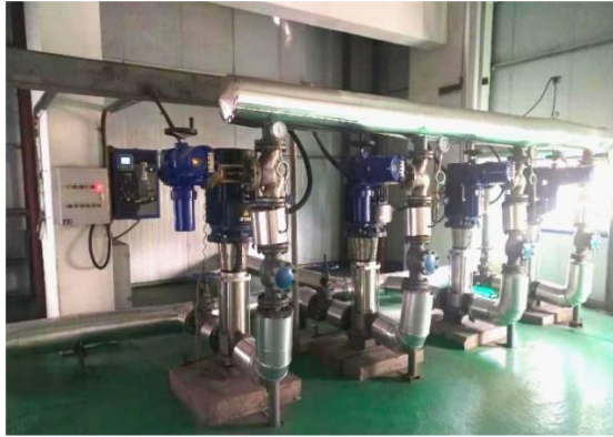
化工凝液回收系统
